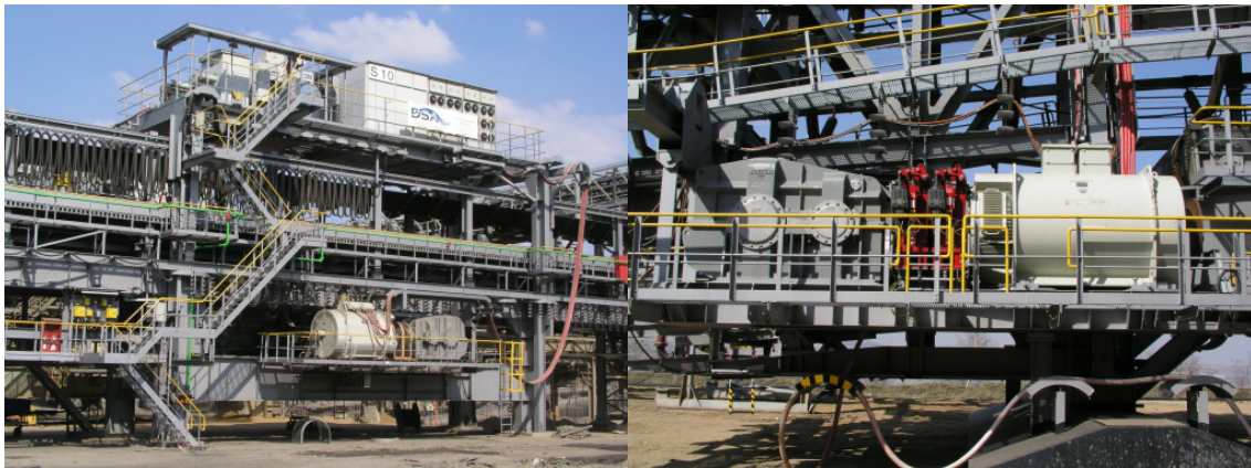
Abbildung 16: Antriebsstation einer Großbandanlage (links) mit Vergrößerung Elektromotor und Getriebe (rechts)
